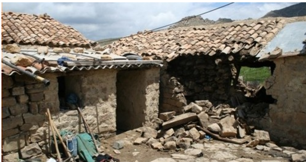
Dégâts observés dans le village de Soma suite au séisme du 14 mai (photo : www.bibans-info.gov.dzv )
