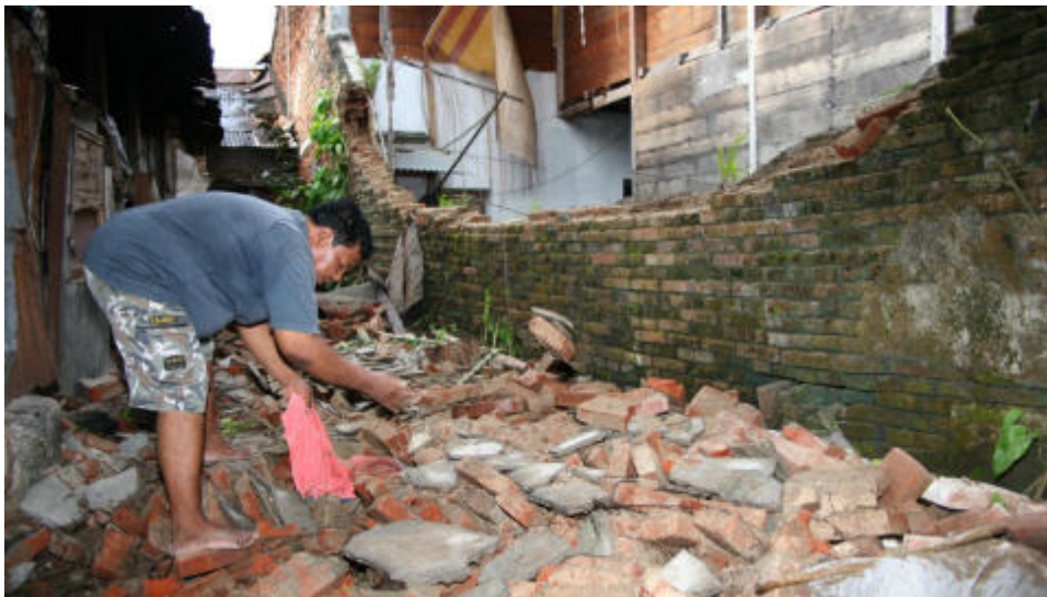
Effondrement d'un mur en briques à Padang, suite au séisme du 16 août 2009 (photo : AFP/Julian Sikumbang)
