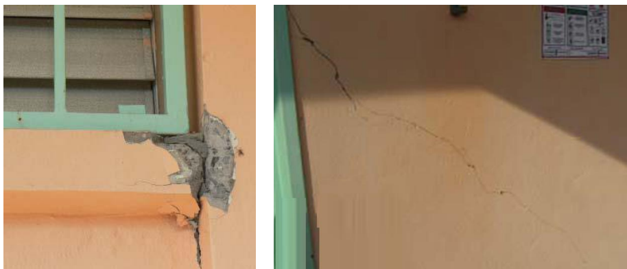
Domages suite au séisme de novembre 2007
