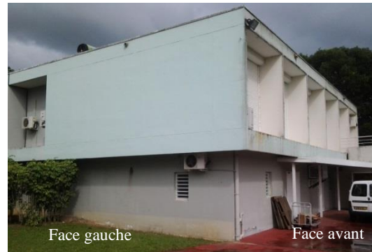
Vue avant renforcement : Encorbellement du RDC sur RDJ, supporté par des voiles en drapeau au RDC
