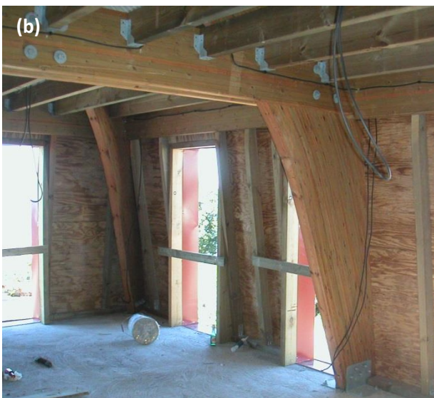
Charpente mansardée en lamellé-collé positionnée au-dessus des deux niveaux maçonnés: (a) vue extérieure arrière gauche et (b) vue intérieure
